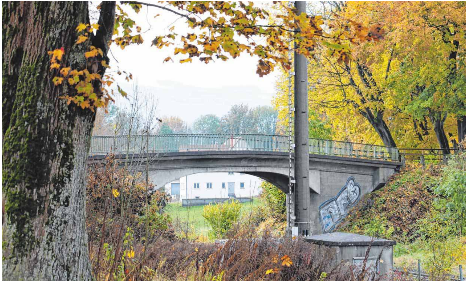
Die Rugetsweiler Brücke ist nicht hoch genug für die Elektrifizierung der Südbahn und zudem stark baufällig.
