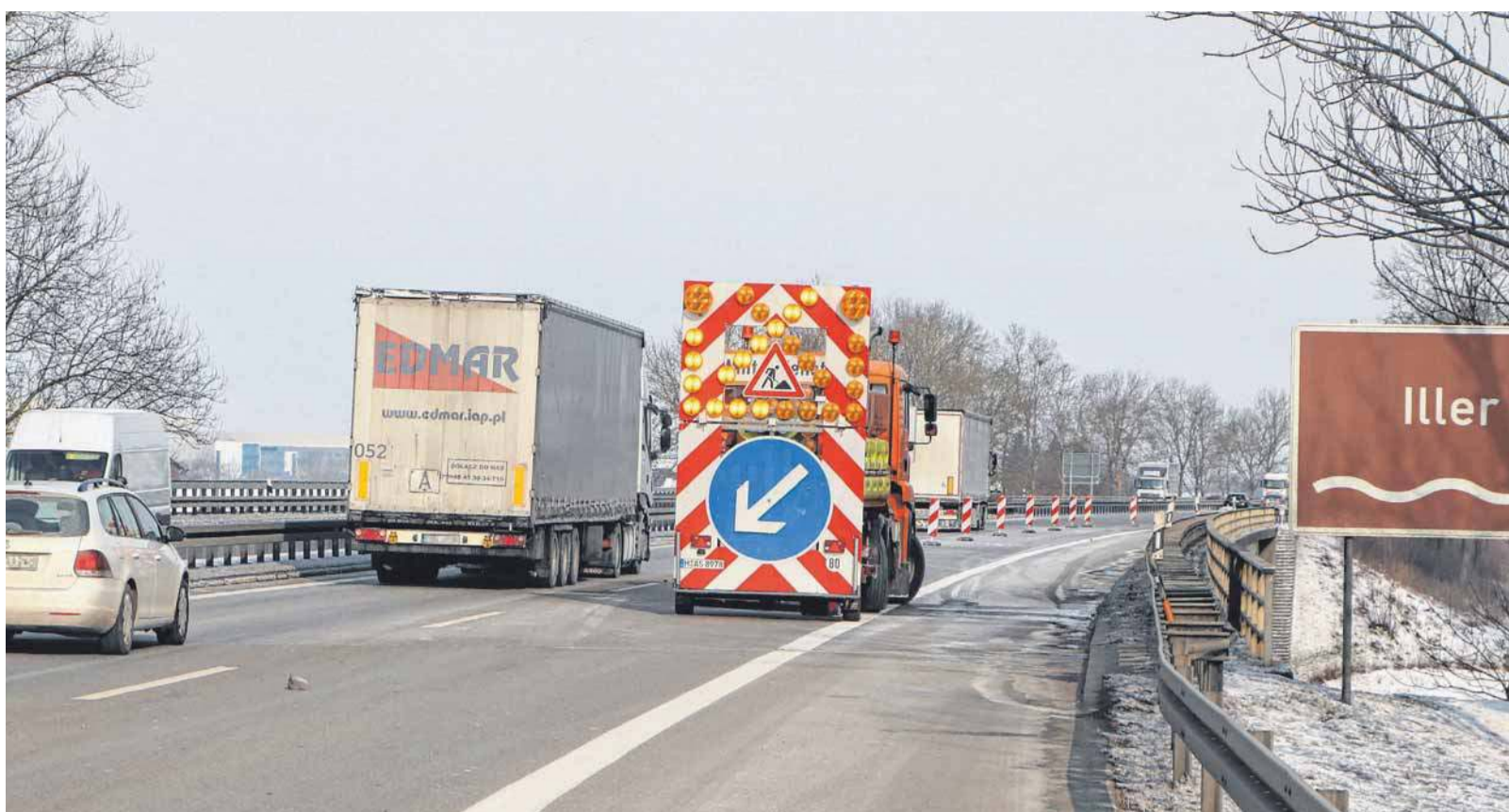
Der Verkehr wird aktuell einspurig und mit reduzierter Geschwindigkeit über die Illerbrücke auf der A 7 zwischen dem Autobahnkreuz Memmingen und der Anschlussstelle Berkheim geführt. Spätestens am Freitag soll die Baustelle beendet sein.
