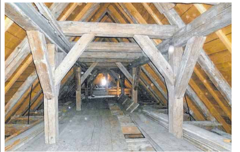
Der sanierungsbedürftige Dachstuhl von St. Petrus und Paulus. FOTO: KATHI KOLB
