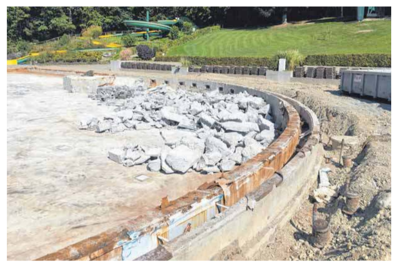
Wo früher die Badesinsel die Mauer des Strömungskanals waren, ist jetzt nur noch ein Haufen zertrümmerten Betons.
