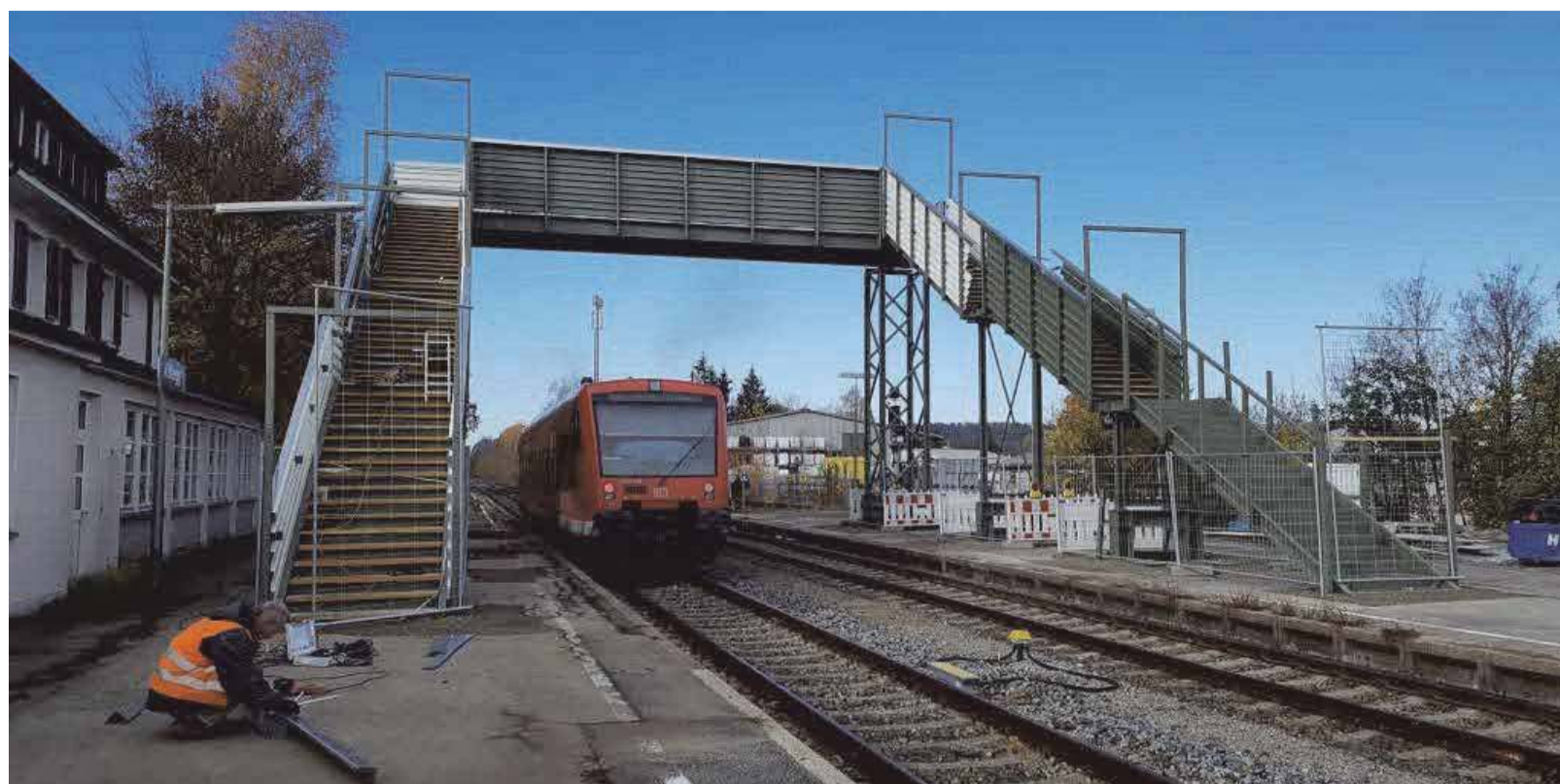
Der Fußgängersteg verbindet die Gleise am Kießlegger Bahnhof nur über Treppen. Er ist übrigens so hoch gebaut, damit die künftige Oberleitung darunter passt.
