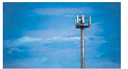
Um Funklöcher zu schließen, sind mehr Mobilfunkmasten nötig. FOTO: DPA
