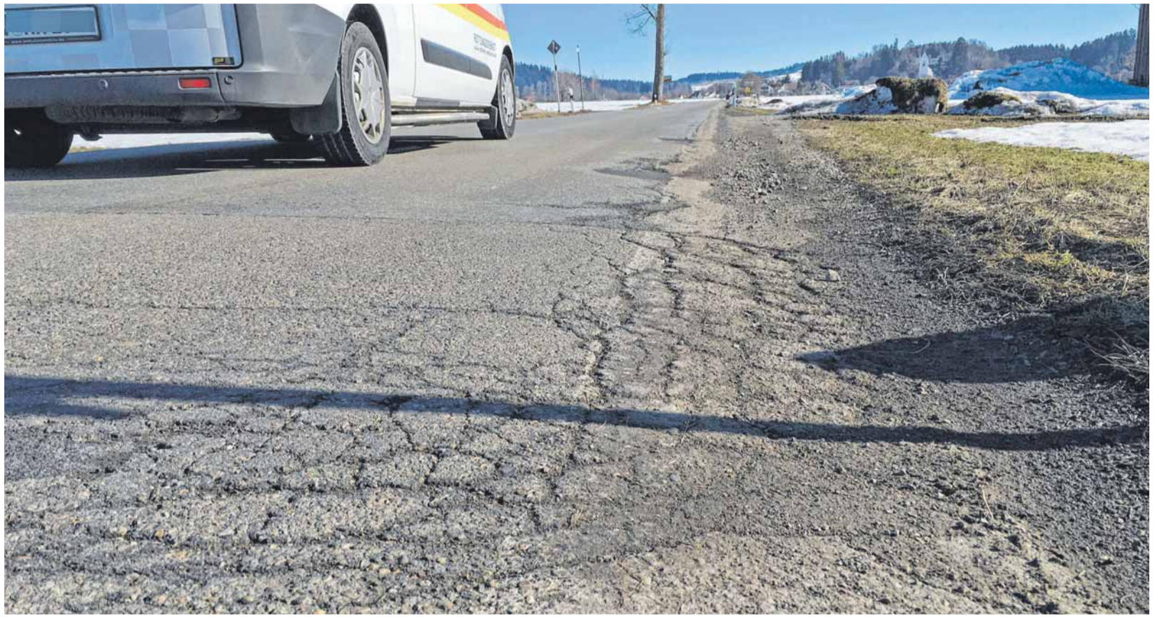
Die L320 bei Friesenhofen ist stark beschädigt. Die Leutkircher Stadtverwaltung sowie Unternehmer fordern einen Ausbau der Straße. FOTO: SIMON NILL
