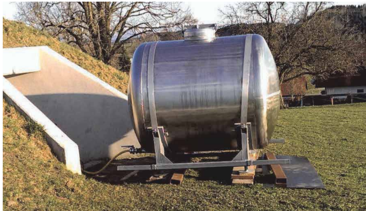
Eine Notwasserversorgung des BDW.
